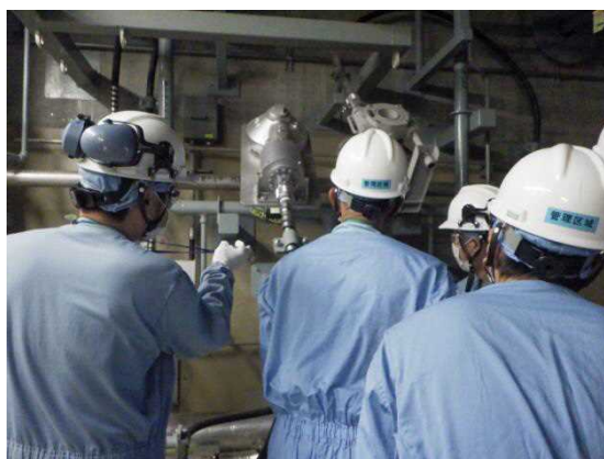
使用済燃料プール代替注水系常設配管を確認
