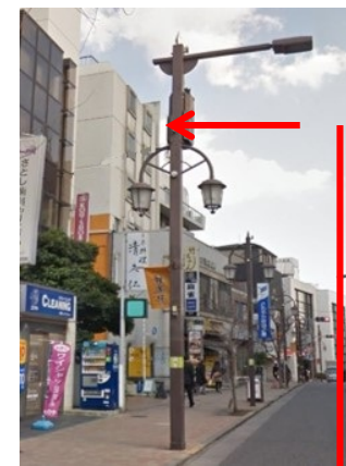
ソフト地中化用変圧器 (照明柱に設置することにより、地上変圧器が不要かつ低コストで整備可能)
