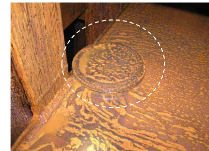
【脱落したエンドキャップ】
