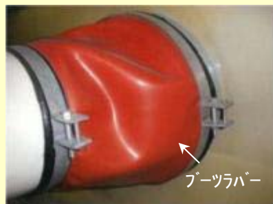
配管貫通部(内側)の例
