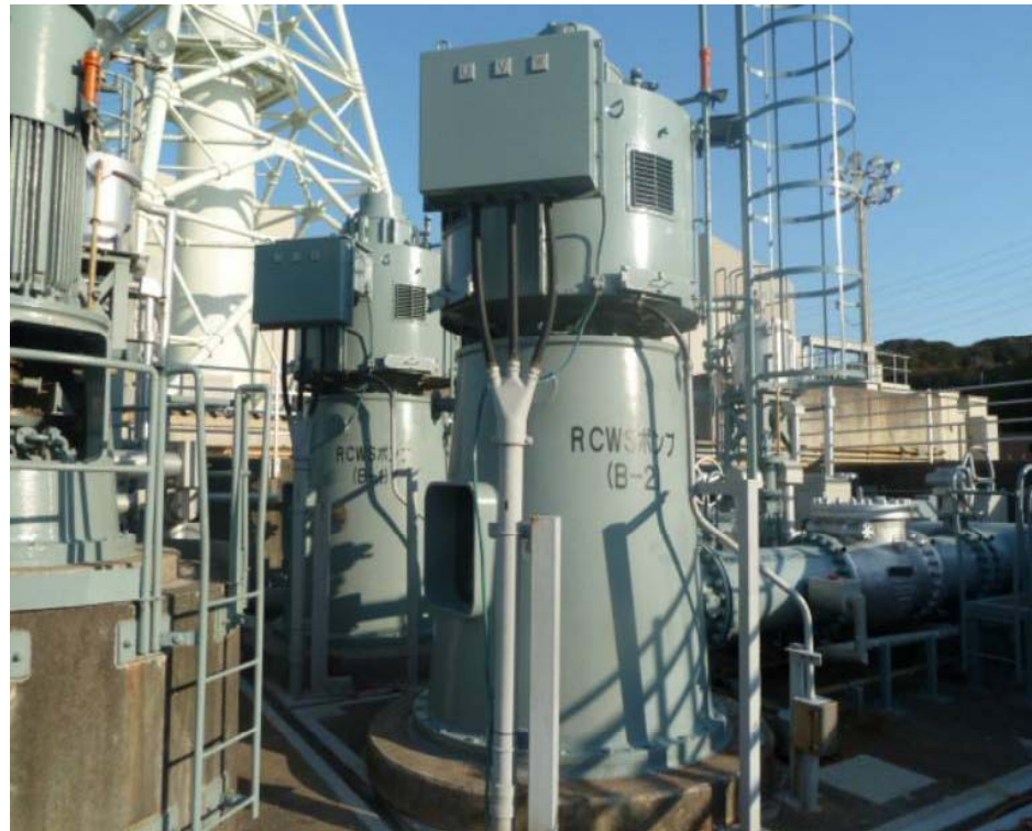
海水取水ポンプ（4号機原子炉機器冷却海水系ポンプ）
