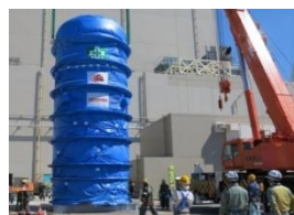
ⓐフィルタベント設備（設置前）
