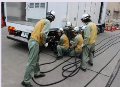
電源車へのケーブル接続訓練
