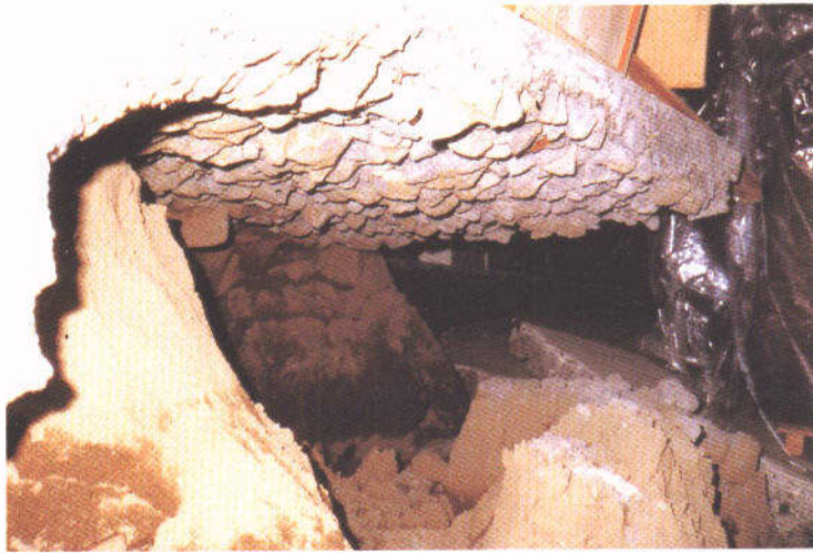
液状化による基礎下の砂の流出
