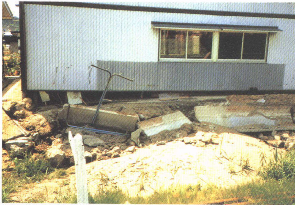
基礎に鉄筋が無く破壊した例
