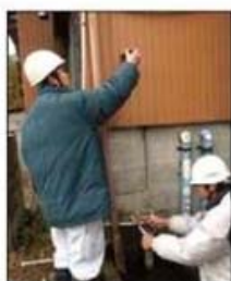
(住宅の傾斜の計測)
