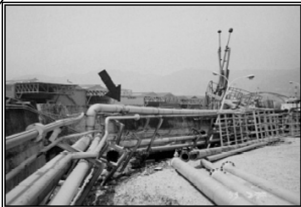
LPガス貯蔵設備の被害（阪神・淡路大震災） （兵庫県南部地震に伴うLPガス貯蔵設備ガス漏洩調査報告書より）
