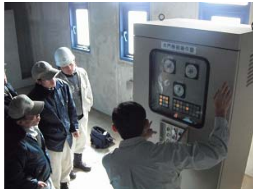
[ 水門機側操作盤点検 ]
