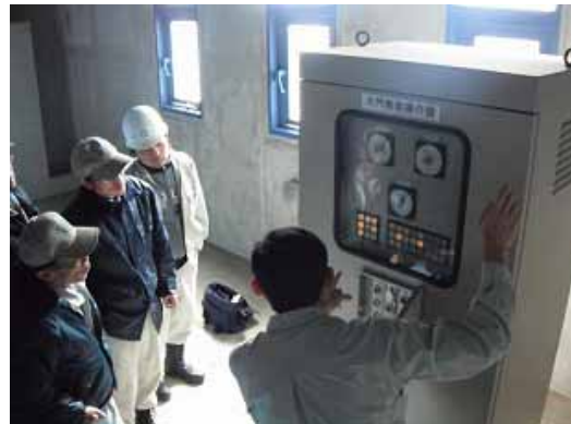
[ 水門機側操作盤点検 ]
