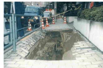
道路の陥没状況②
