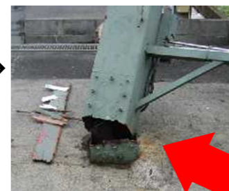
折れた柱の根元。点検口のボルト穴からサビが入り腐食して、鉄骨が破断した。
