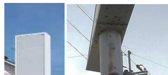
↑看板本体からポールへの汚ダレがあると、接合部にサビや腐食が進行する恐れ。
