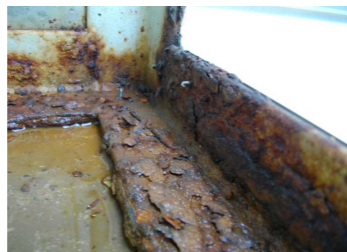
↑看板面(アクリル板)のひび、割れ、ゆがみ板面の落下により、内部に水が入り腐食する原因に。
