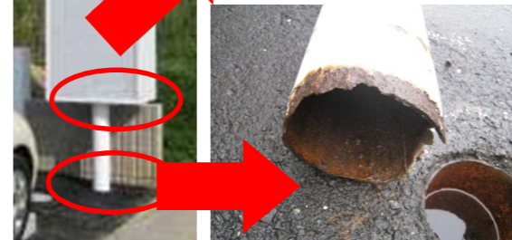
↑柱根元のサビを放置し、倒壊。
