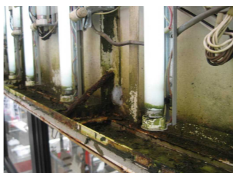
↑内照式看板内部の腐食、部材の腐食器具の劣化による出火の恐れも。
