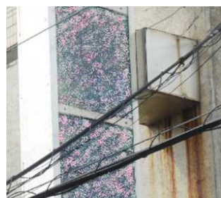
←ブラケット下に汚ダレが見られると、内部の取付金具にサビや腐食の可能性もある。
