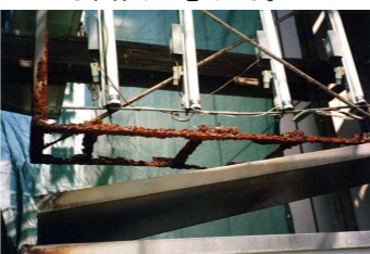
↑看板底部の脱落
