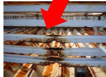
↑目隠しルーバーのサビ・腐食。
