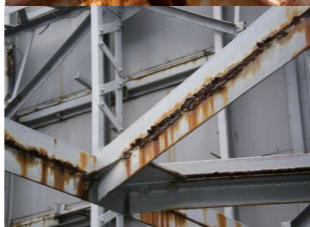
↑内部鉄骨のサビ・腐食。
