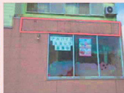
落下した後の壁面
