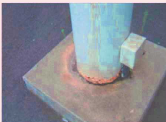
ポールの根元にサビが発生
