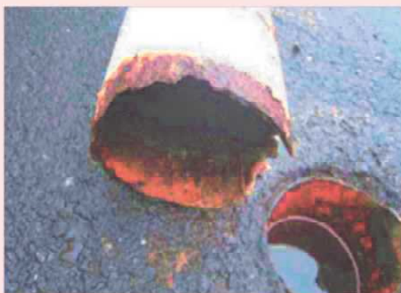
ポールの根腐れによる倒壊
