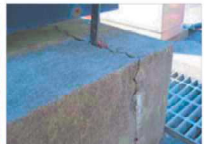
看板基礎のひび割れ
