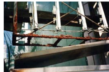
↑看板底部の脱落
