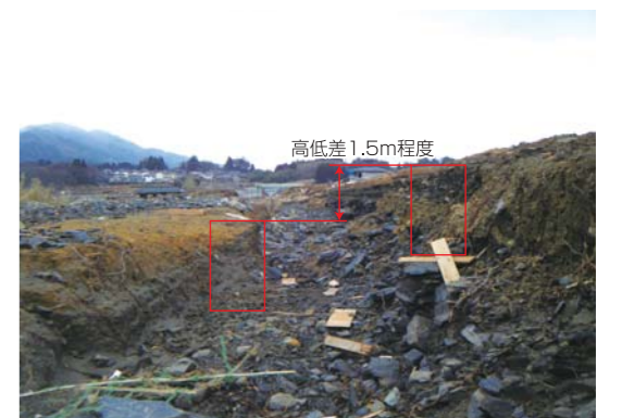
沈下の状況 (陸前高田市) (写真提供:静岡県支援先遣隊)
