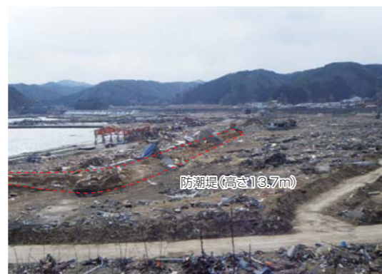
津波で破壊された防潮堤 (宮古市田老海岸) (写真提供:静岡県支援先遣隊)
