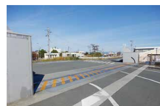
陸上設置型フラップゲート式可動防潮堤(陸閘)
