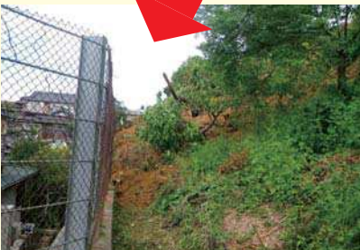
がけ崩れから人家を守った急傾斜施設 (浜松市西区庄和町)
