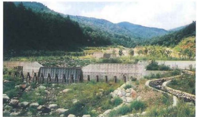
湯舟川床固工群
