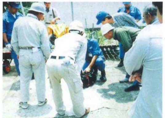
可搬式発電機の点検
