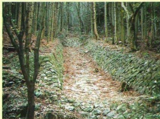
木和田川1号流路工
