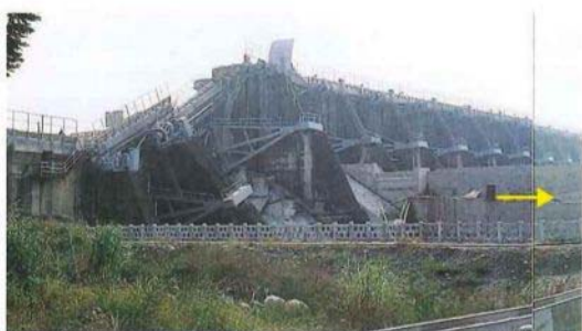
逆断層の食い違い変位により破壊された石岡ダム
