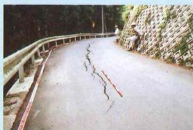
「地八」地すべりの被災状況
