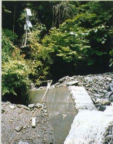
土石流により破断した坂本川-1センサー
