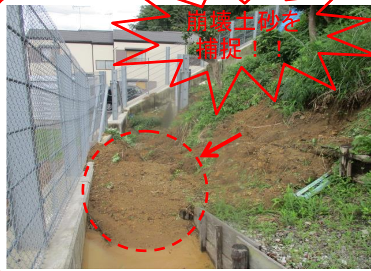
がけ崩れ発生直後 (R01.7.23)
