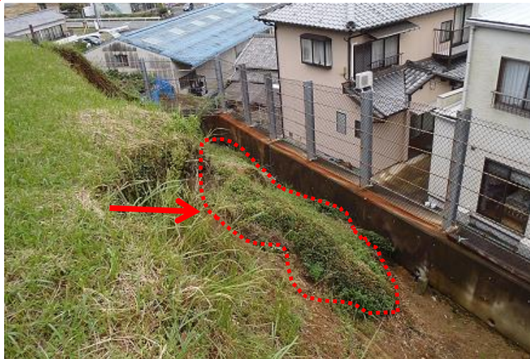
がけ崩れ発生直後 (H29.10.25)
