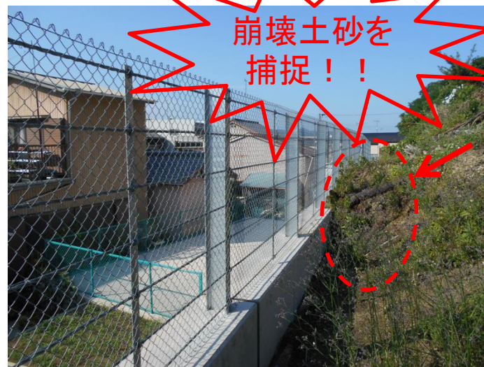
がけ崩れ発生直後 (H29.6.23)
