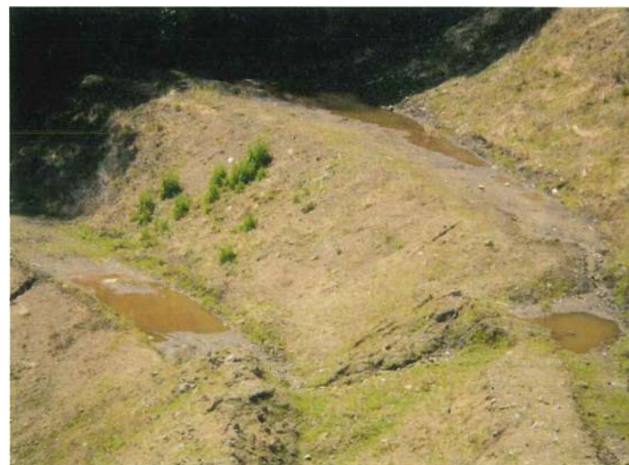
小段勾配の処理の悪さによる盛土法面の水溜り
