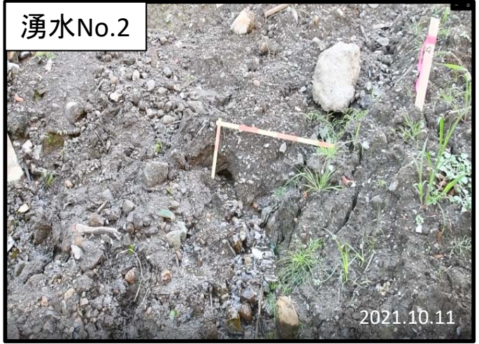
湧水No.2 崩土と地山の境界 地山は茶色粘土層の土壌
