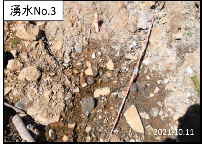
湧水No.3 地山内または崩土と地山の境界 地山は礫混じり風化土壌(崖錘堆積物)
