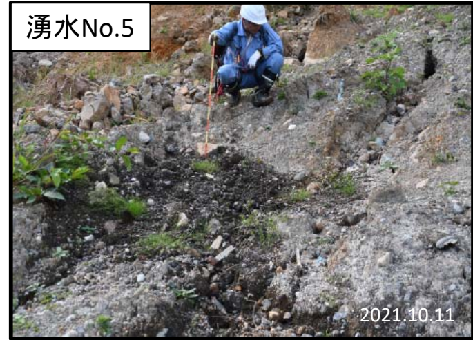
湧水No.5 崩土上部 湿地上に湧水
