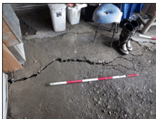
地すべりによる人家床の亀裂
