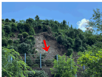
菊川市高橋（斜面正面より） 【崩壊高6m、崩壊幅9m】
