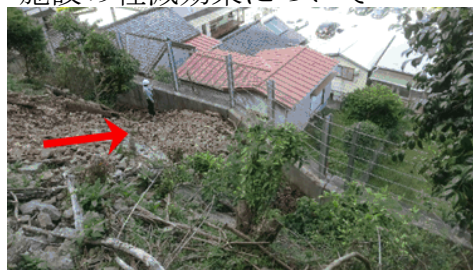
下田市西本郷（斜面上部より） 【崩壊高5m、崩壊幅10m】
