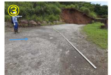
崩壊地の上部に生じたクラック
