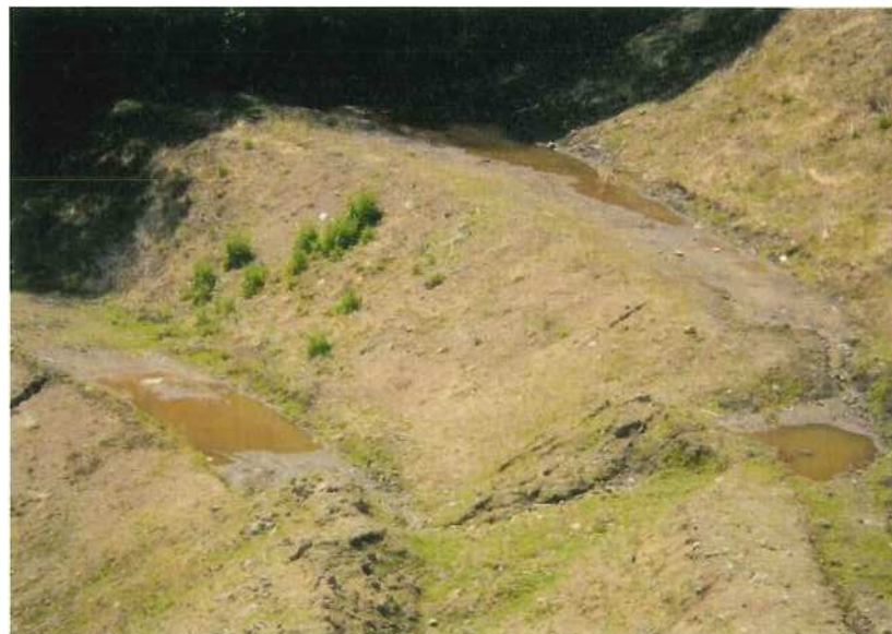
小段勾配の処理の悪さによる盛土法面の水溜り
