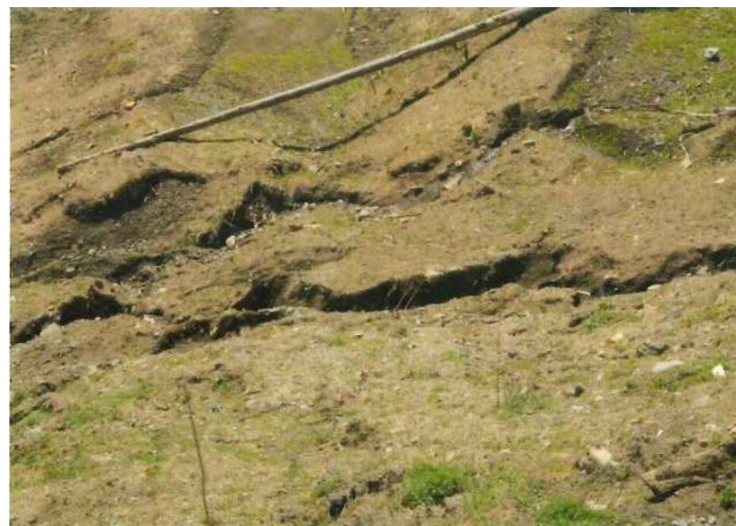
法面の浸食発達状況
