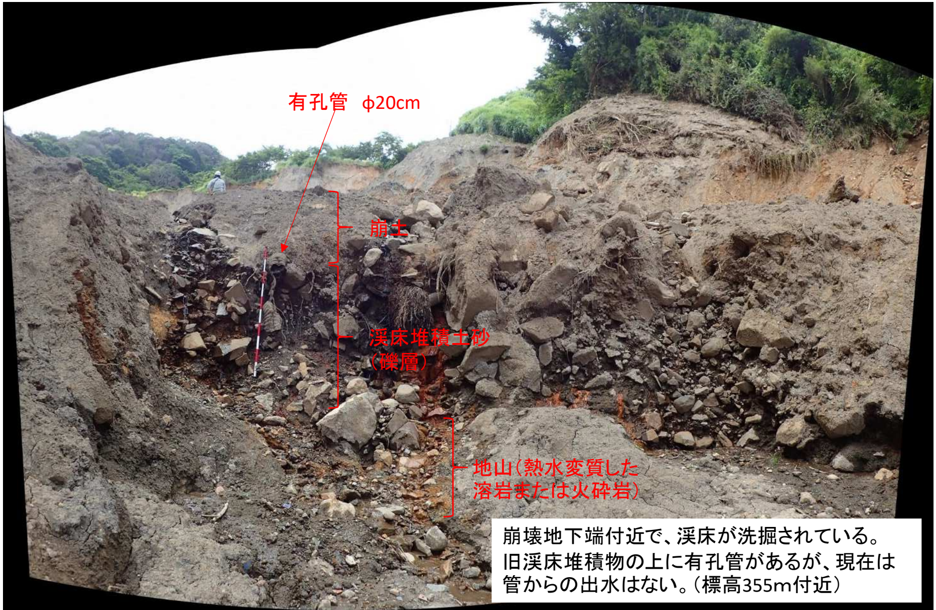
写真-11 2021年8月2日 崩壊後の盛土下端部
