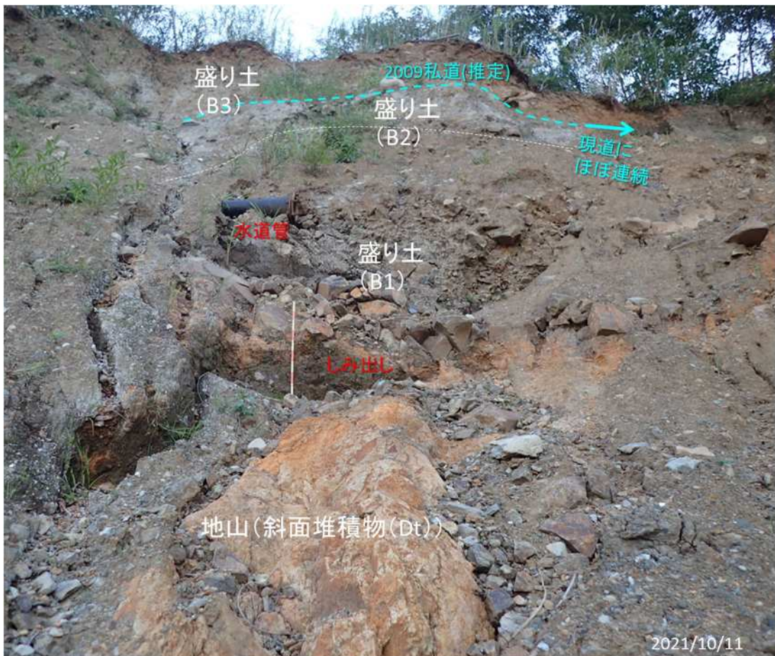
写真④ 左岸側崩落地の露頭
