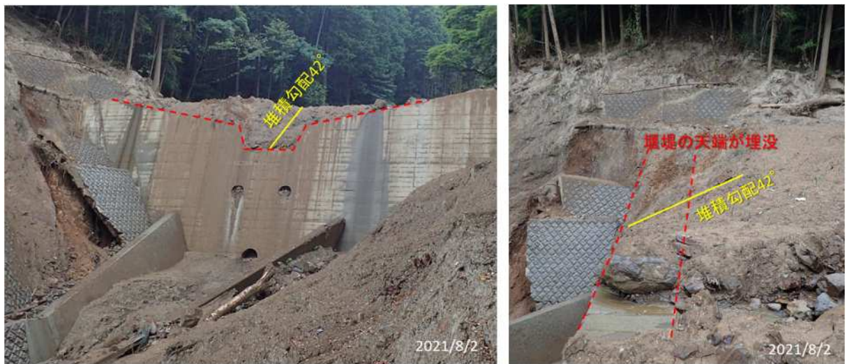
写真② 崩落地から約 400m 下流にある砂防堰堤
