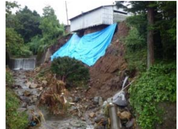
3 一級河川用沢川 護岸決壊 (裾野市下和田) 平成27年の異常気象及び復旧費(件数、金額)
