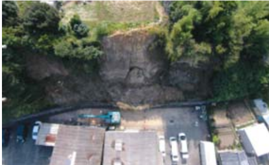
1 地下No.2(急傾斜施設) 法面崩壊 (浜松市西区大人見町)
