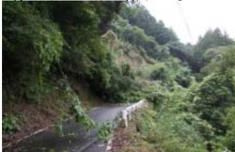
4 市道丹間線 法面崩壊(掛川市丹間)
