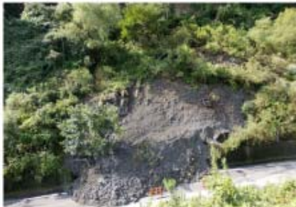
5 市道千羽木割線 法面崩壊(掛川市本所)
