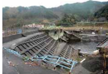
《堤防被災状況》
