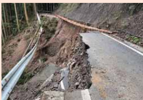
県道久連子落合線の被災状況(八代市泉町栗木)
