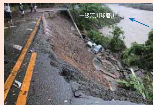
国道219号の被災状況(八代市坂本町荒瀬)
