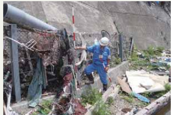
津波により変形した支柱
