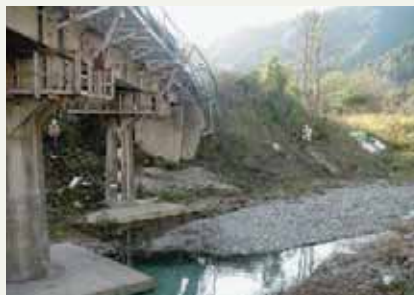
水海川被災状況
