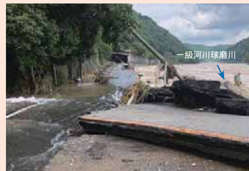
国道219号の被災状況(球磨郡球磨村渡)
