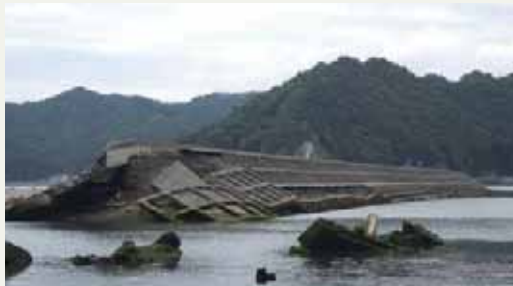
片岸地先海岸防潮堤被災状況
