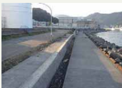
防潮堤の倒壊
