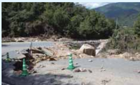
道路の被災状況(土石流により路肩が崩壊)
