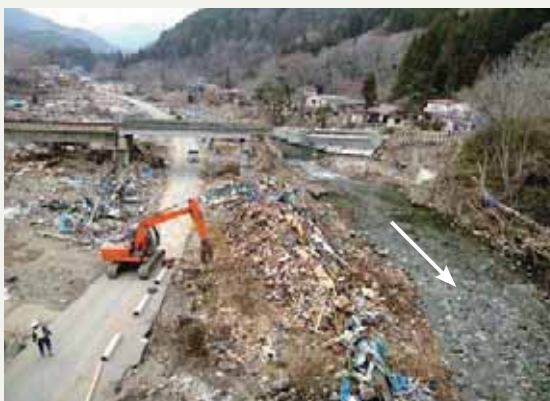
片岸川の被災状況
