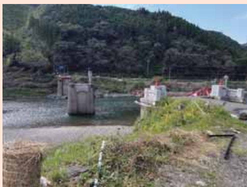
橋脚を残し落橋した橋梁(球磨川)
