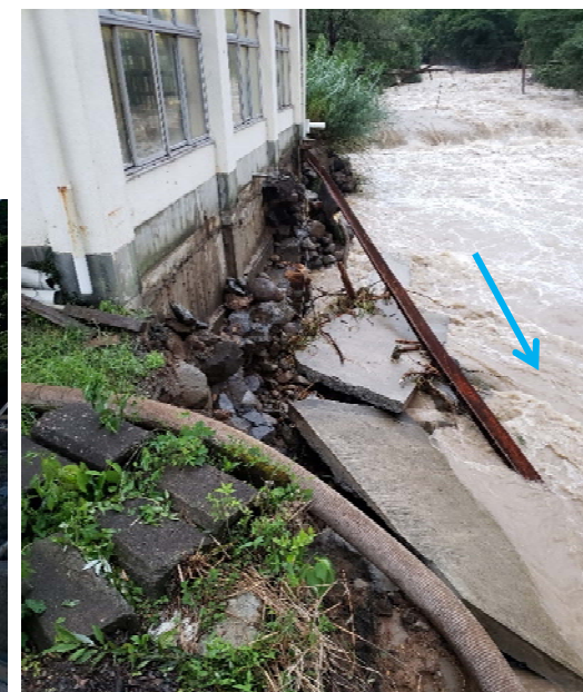
被災箇所を下流からのぞむ
