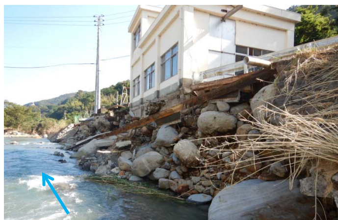
町取水場上流より、被災箇所をのぞむ
