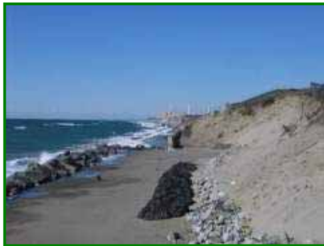
侵食による護岸崩壊
