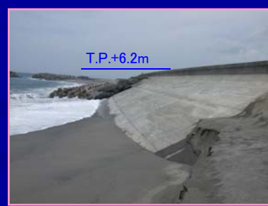
波が直接堤防に作用(H21.7)
