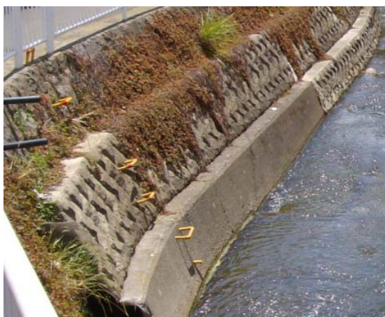
図-2.15 河川空間利用の状況（河道内へ下りるためのステップ）
