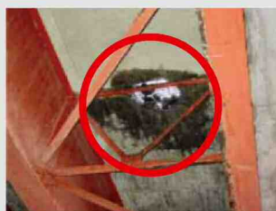
車両通行箇所の抜け落ち
