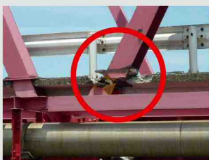
トラス橋材の破断
