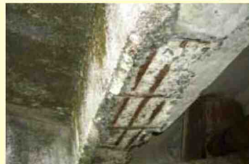
② コンクリート橋(剥離・鉄筋の露出)
