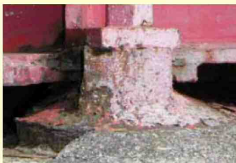
③ 鋼橋(鋼支承の腐食)
