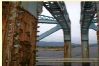
① 鋼橋(塗装の劣化)
