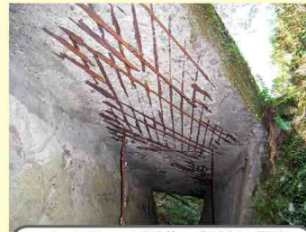
コンクリート剥落・鋼材の露出
