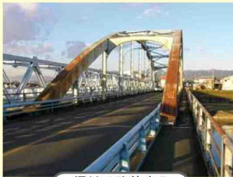
鋼材の塗装劣化
