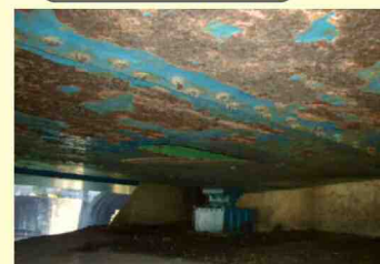
④ 床版(補強材の再劣化)
