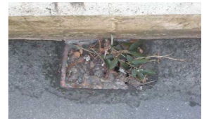
排水樹の土砂詰り
