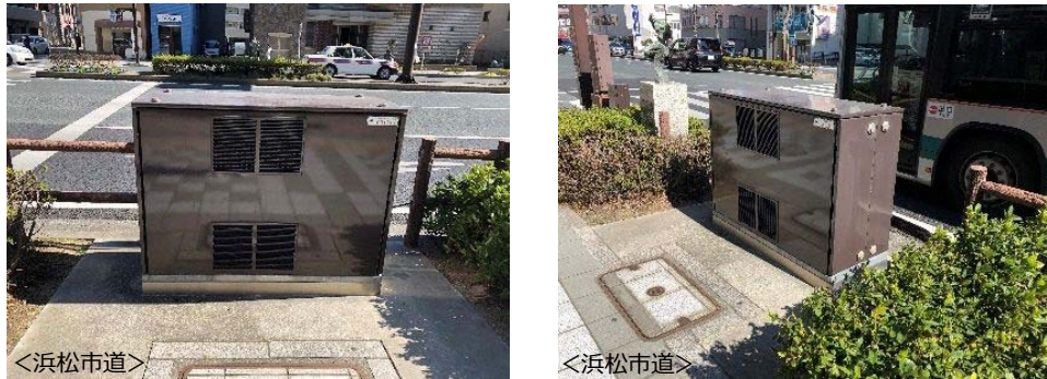
写真 3-2 地上機器の例
