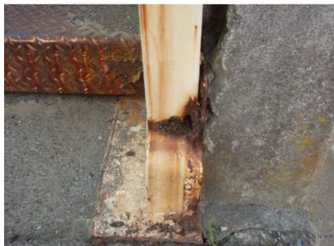
橋台接合部の腐食
