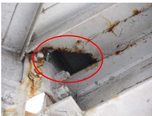
写真 4-3 鋼材の腐食による落下
