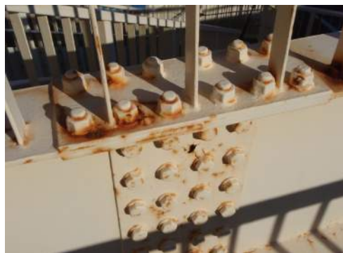
主桁接合部の錆び
