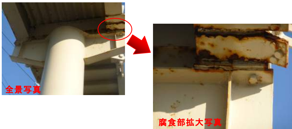
写真 2-1 支柱の腐食事例
