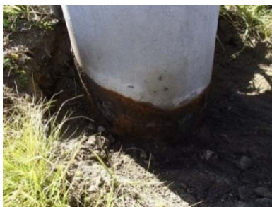
門型標識 地面境界部支柱の腐食
