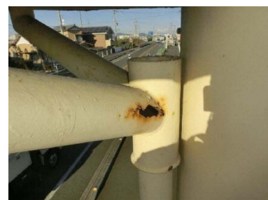
排水管の腐食
