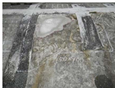
シエツド 主梁補修材のうき
