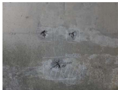
大型カルバート 剥離・鉄筋露出
