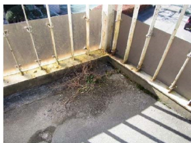
排水施設の土砂詰まり
