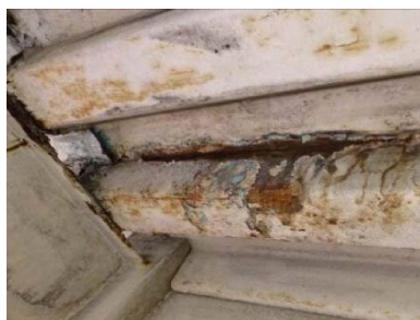
横断歩道橋 床版の腐食
