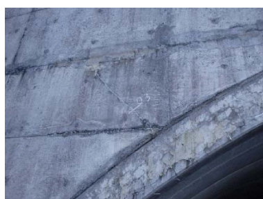
カルバートウイングのひび割れ
