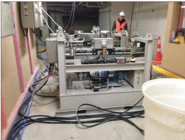
注入装置(ポンプ)
