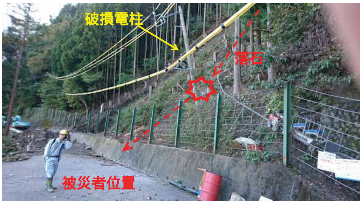
落石が電柱に当たり、破片が飛散
