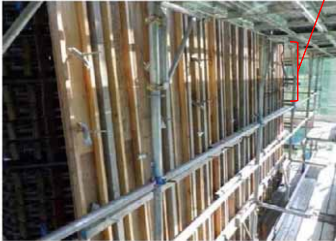
落下した型枠全景
