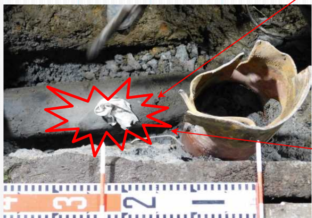
水道管破損状況
