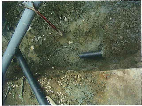
上流側温泉管切断部
