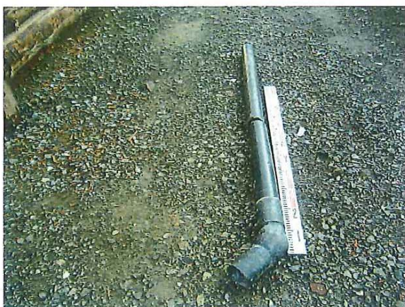
新設温泉管φ75破損箇所
