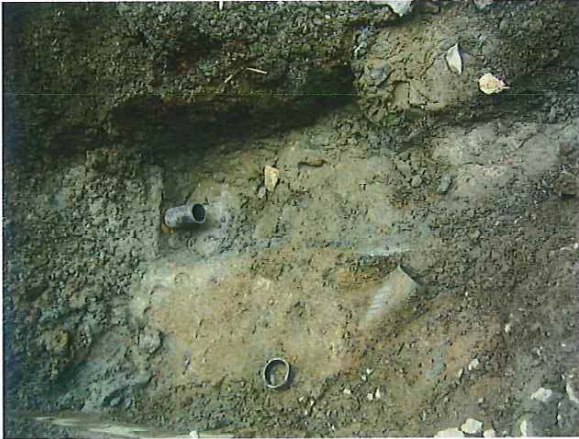
下流側温泉管切断部
