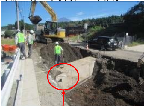
水道管破損箇所
