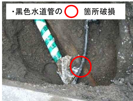
事故現場の状況写真
