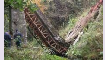
香川・徳島県境無名橋の落橋 (2007年)
